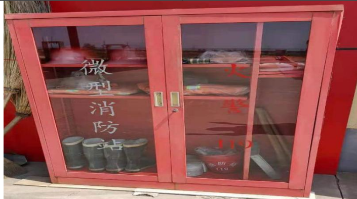
图 3-8 储油罐消防设施
