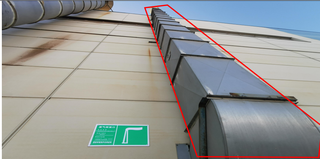
图 3-7 喷漆房排气筒
